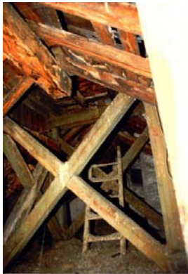
Comble - Base du campanile et les fientes de pigeons.
